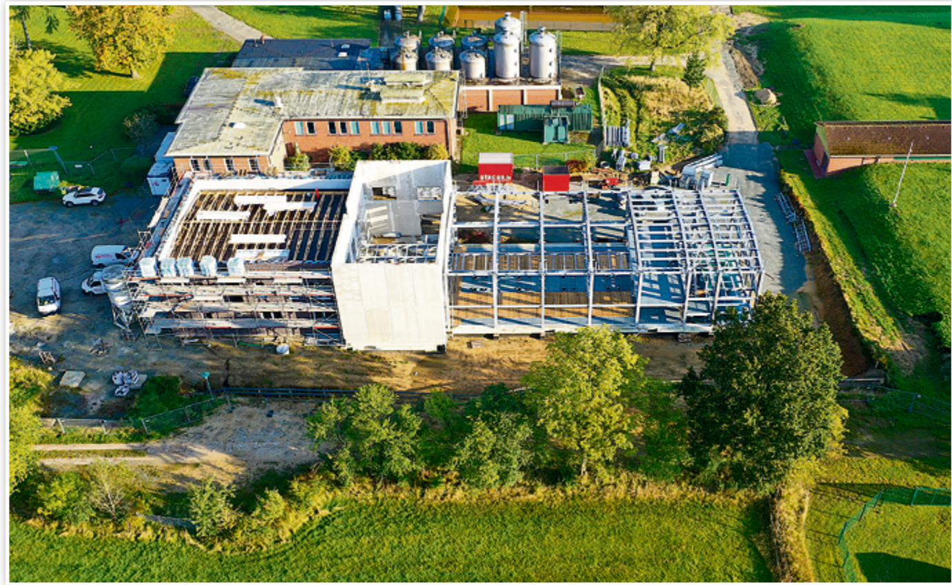
Durch das noch geöffnete Dach werden in diesen Tagen die acht Filter „eingeflogen“.
