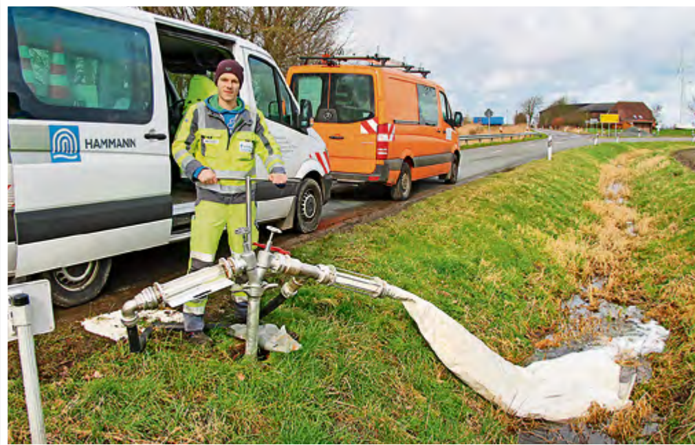
Am Hydranten hat Mike Dunker vom Wasserverband das Spülwasser im Blick.
