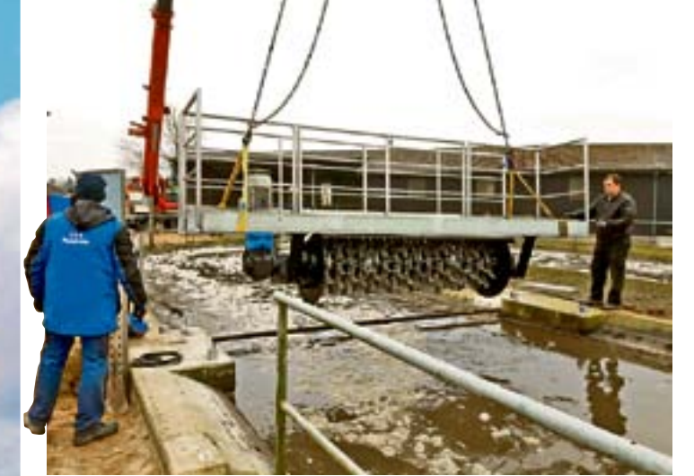
Die Walzenbelüfter, die für den benötigten Sauerstoff in der biologischen Reinigungsstufe sorgen, wurden kürzlich auf der Kläranlage Hennstedt erneuert (siehe Foto). Außerdem wechselt der WVND nach gut 40 Jahren die E-Technik aus. In beide Baumaßnahmen fließen zusammen etwa 450.000 Euro. Foto: WVND
